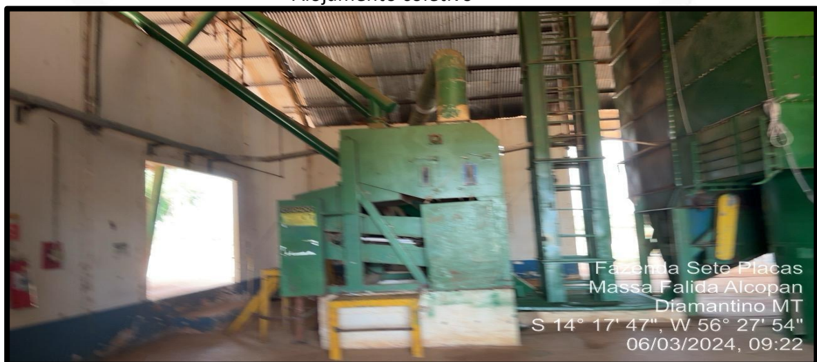
Pré – limpeza e Elevador
